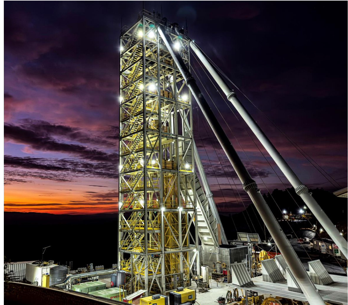
La Colorada Ventilation Shaft
